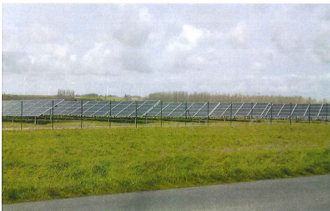
Centrale photovoltaïque au sol- commune d'Issoudun-photo DDT 36 (mars 2020)
