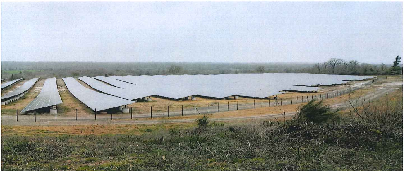
Centrale photovoltaïque au sol- commune de Chaillac -photo DDT 36 (mars 2020)
